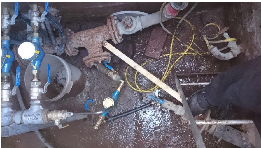
Bild 2, ombyggd koppling för mätare 11482 i Lycka
