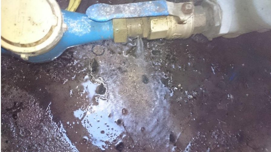
Bild 1, vattenläcka i Lycka
